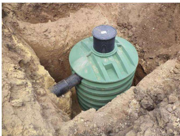
6. sz. Kép: Telepített tartály
